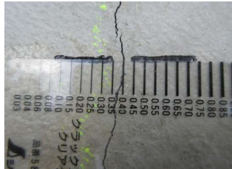
写真2.ひび割れ幅確認
