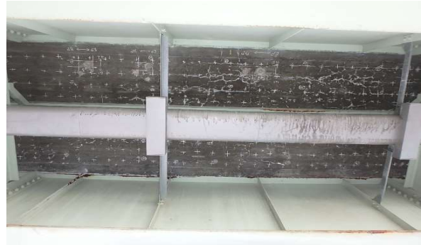
写真2.測定点及び床版ひび割れ状況
