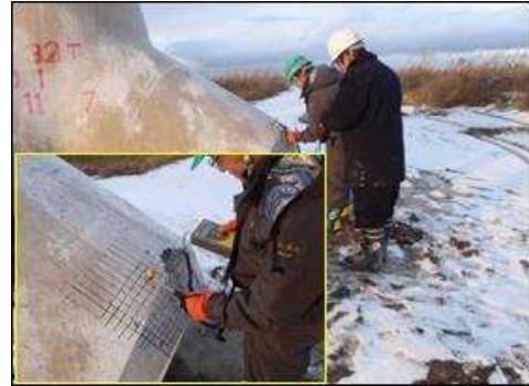
写真2.強度・劣化・はく離状況確認
