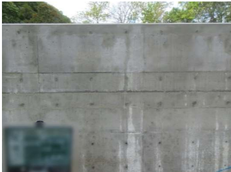
写真1.ひび割れ発生状況
